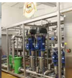
Production d'eau osmosée
