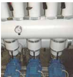
Circulation d'eau glacée
